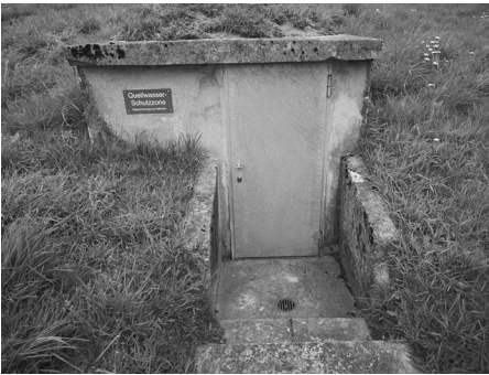
Brunnenstube «Katzenrücken» alt (Baujahr 1927)
