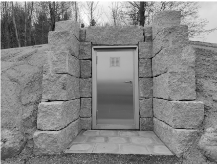
Brunnenstube «Rainhau» neu (Baujahr 2021)
