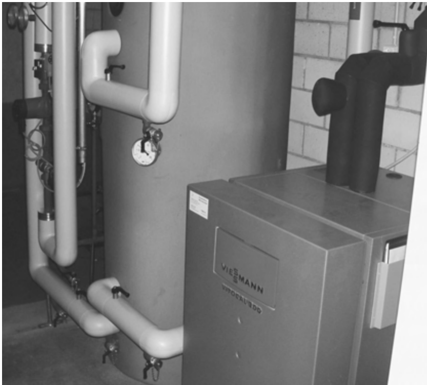
Wärmepumpe und Zwischenspeicher
